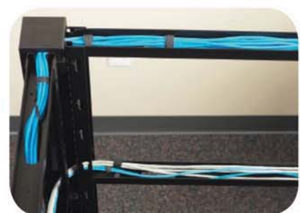
In-Panel Cable Raceway // // // //
